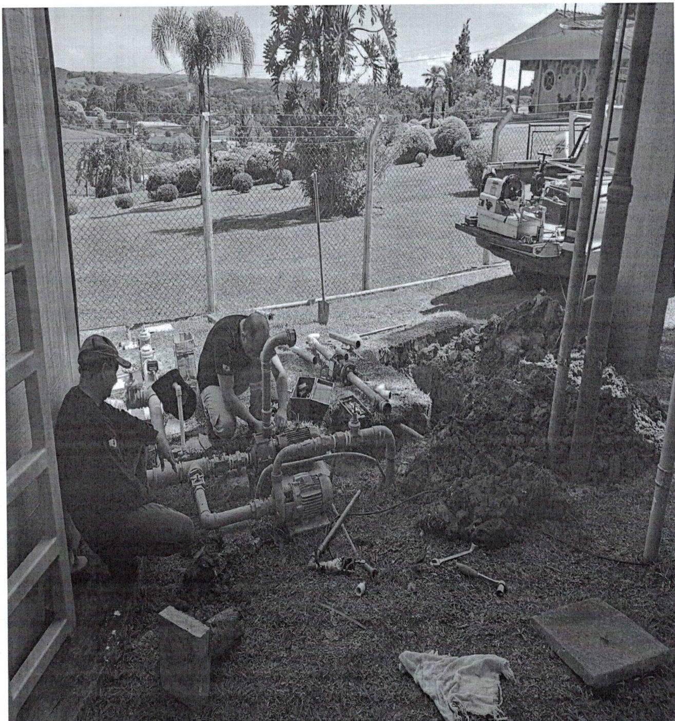
Nova bomba instalado com mais vazão e potência.
